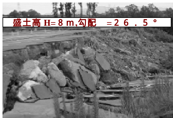
写真 1. C材盛土法面の崩壊事例
